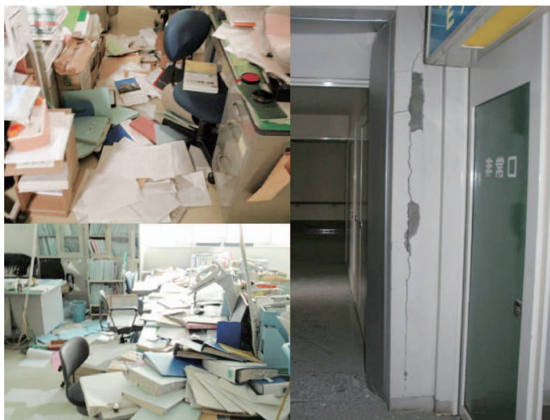
図2 発災直後の院内の被害状況
