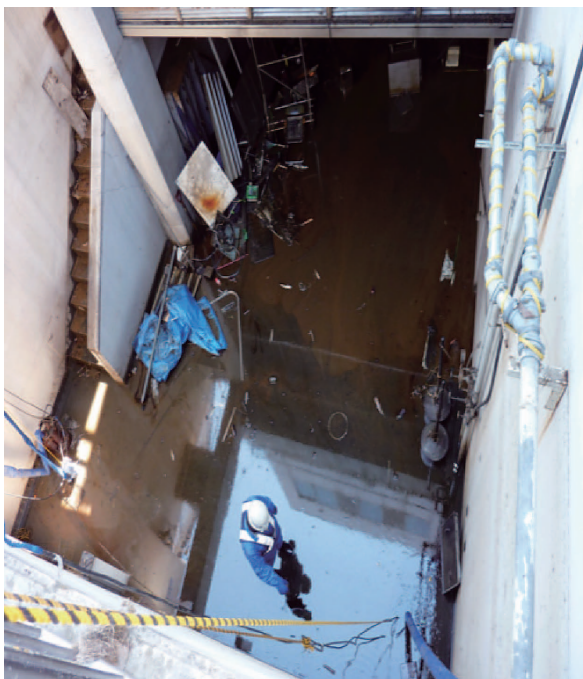
水を除去した地下。泳いでいた魚は死んだ。
