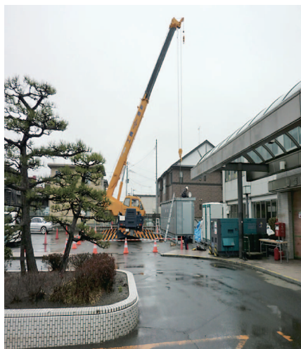
仮設トイレの奥に設置中の安定受電に必要なキュービクル
